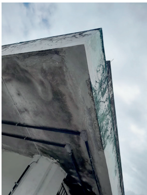
Foto: Infiltração na parte inferior da marquise.
